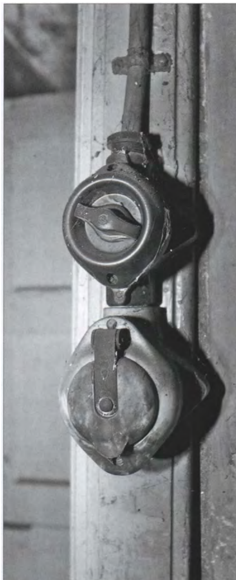
Origineel schakelmateriaal uit de bouwtijd van de bunker: (foto's: R. Vossebeld)
